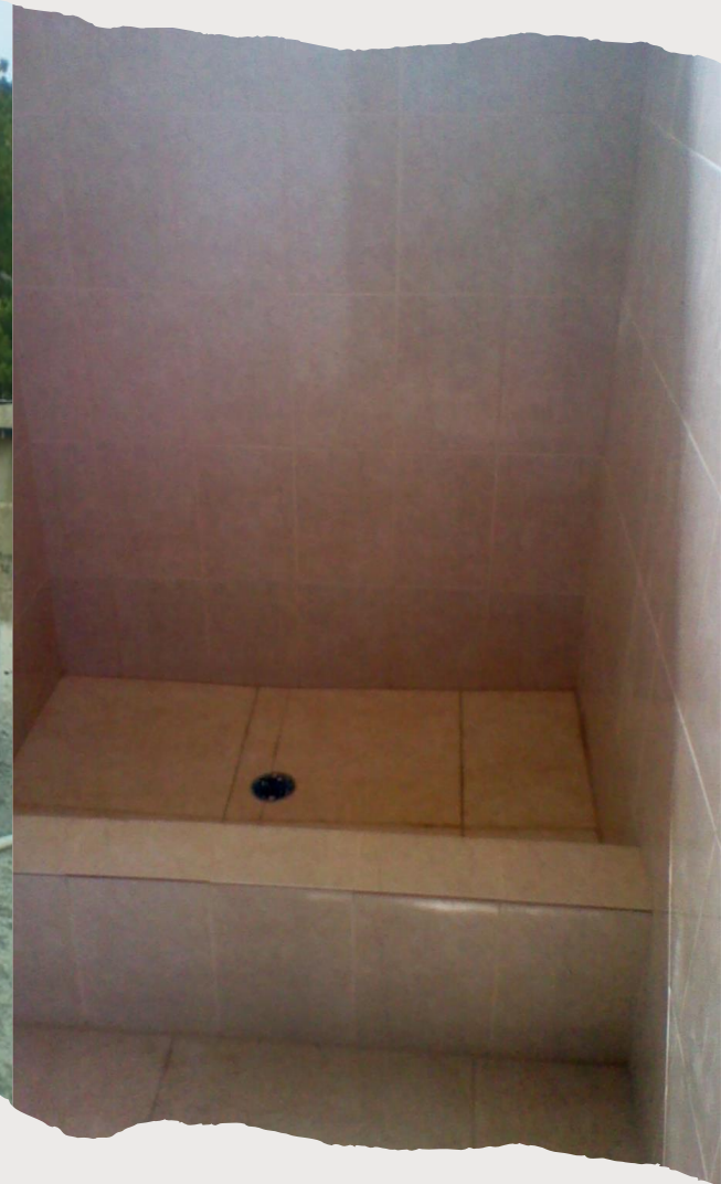
Equipements sanitaires: WC, douches, Château d'eau (2014)
